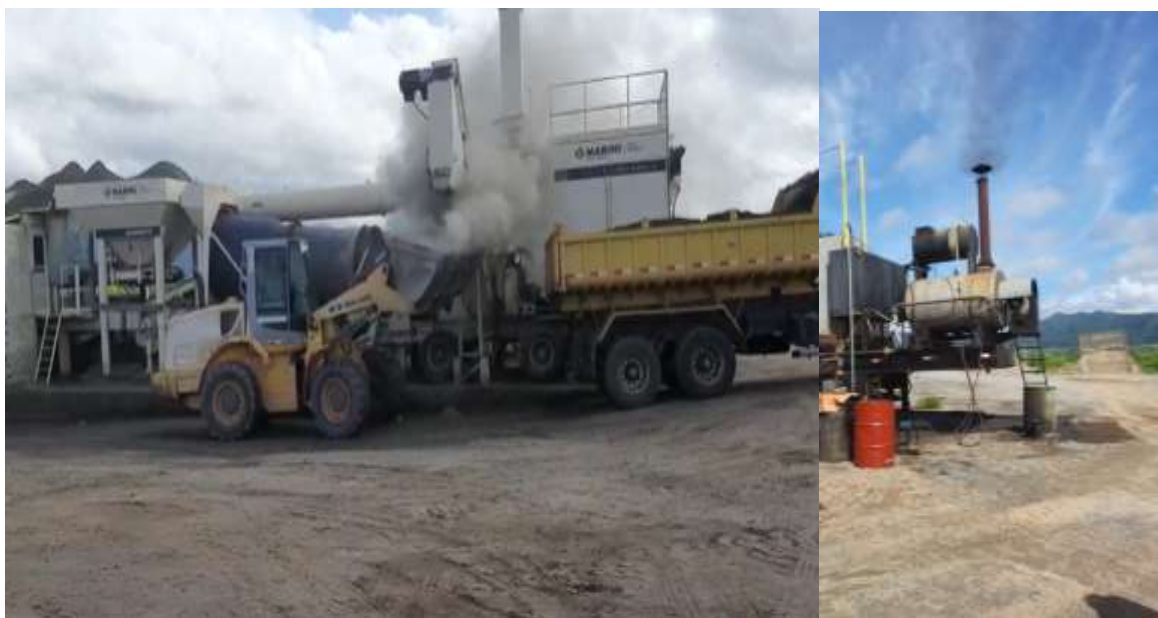
Figura 2: (a) Poeira suspensa no ar ao transportar o material asfáltico para obras, (b) Vazamentos de vapor no processo.
