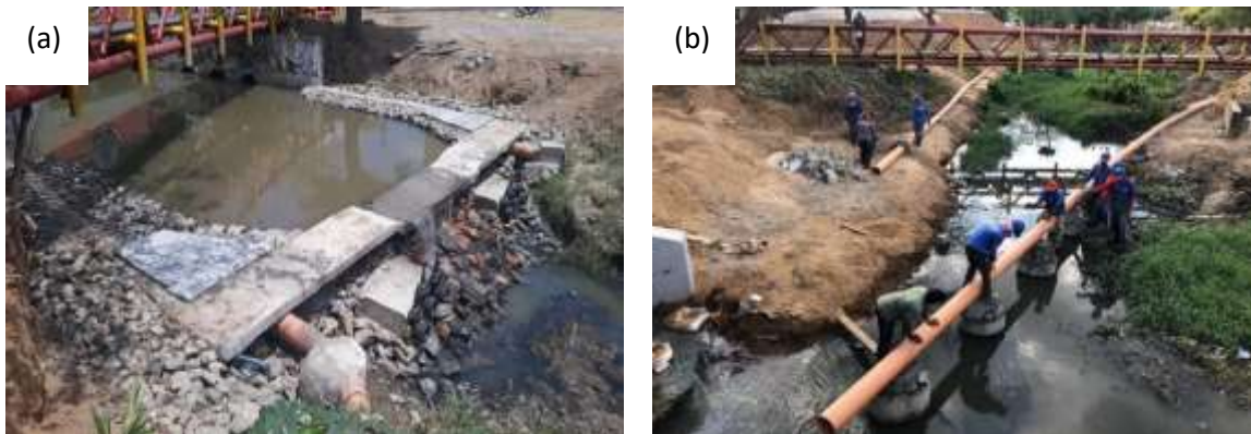
Figura 6 – Rede de alimentação dos SAC's: (a) Caixa de areia; (b) Tubulação de transporte.
