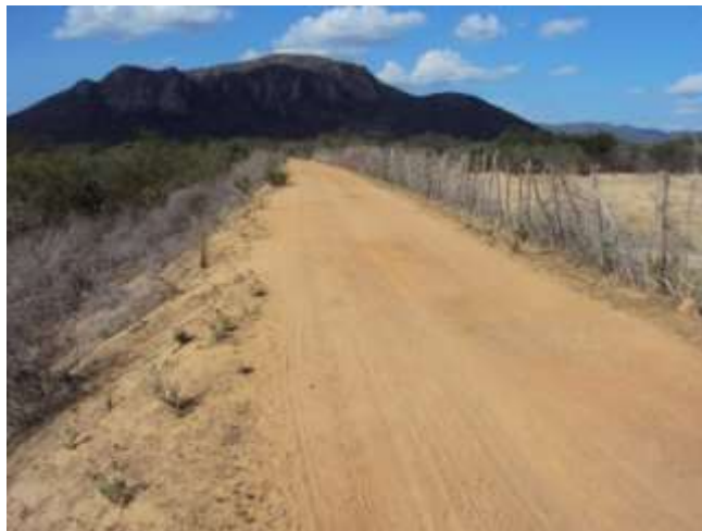
Figura 12 - Estrada de terra que passa em cima da crista da barragem.
