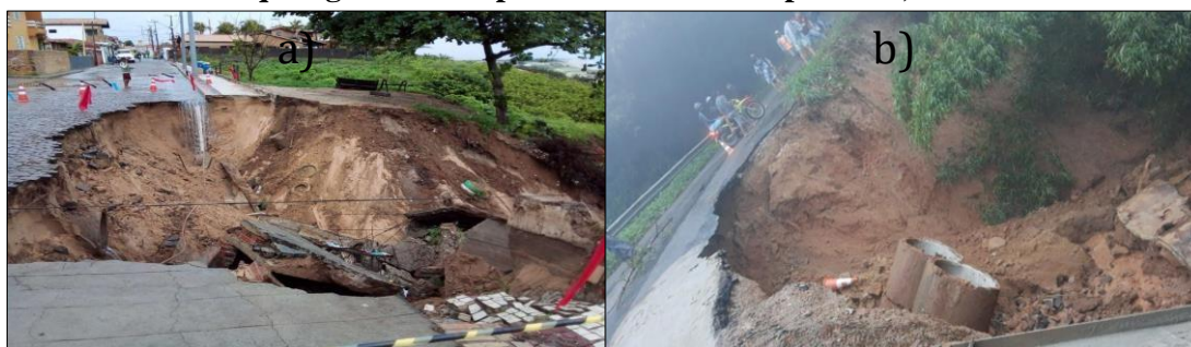
Figura 6 – Movimentos de massa: a) em Beberibe (CE), em março de 2021; b) na rodovia CE-257 que liga os municípios de Aratuba e Capistrano, em maio de 2021.
